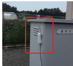
地上(通信装置)
