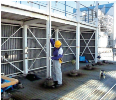
[測定分析事業] 火力発電所における排ガス測定
