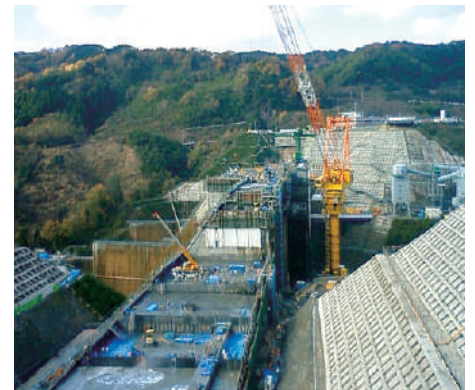
[石炭灰販売] フライアッシュセメントを使ったダム工事
