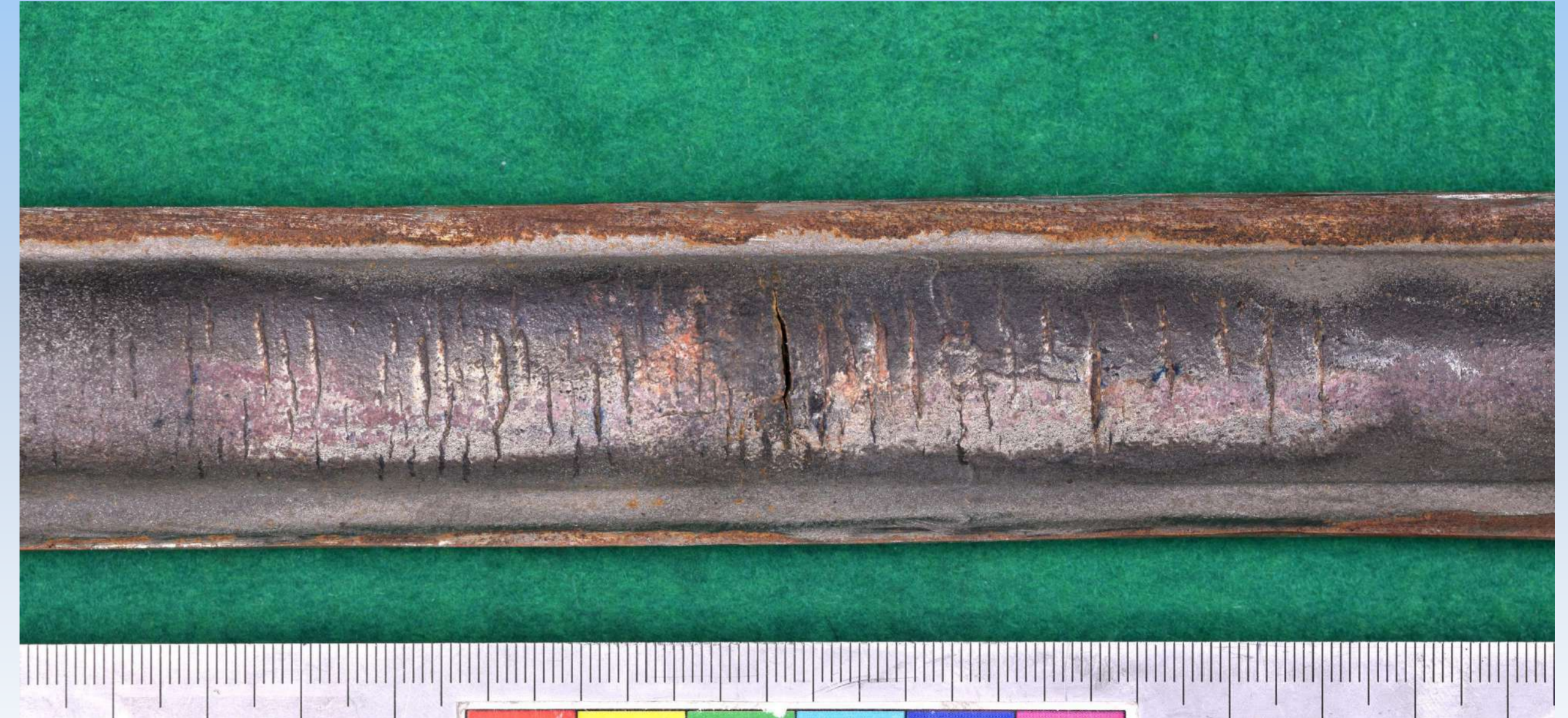
トラブルで損傷した蒸発管
