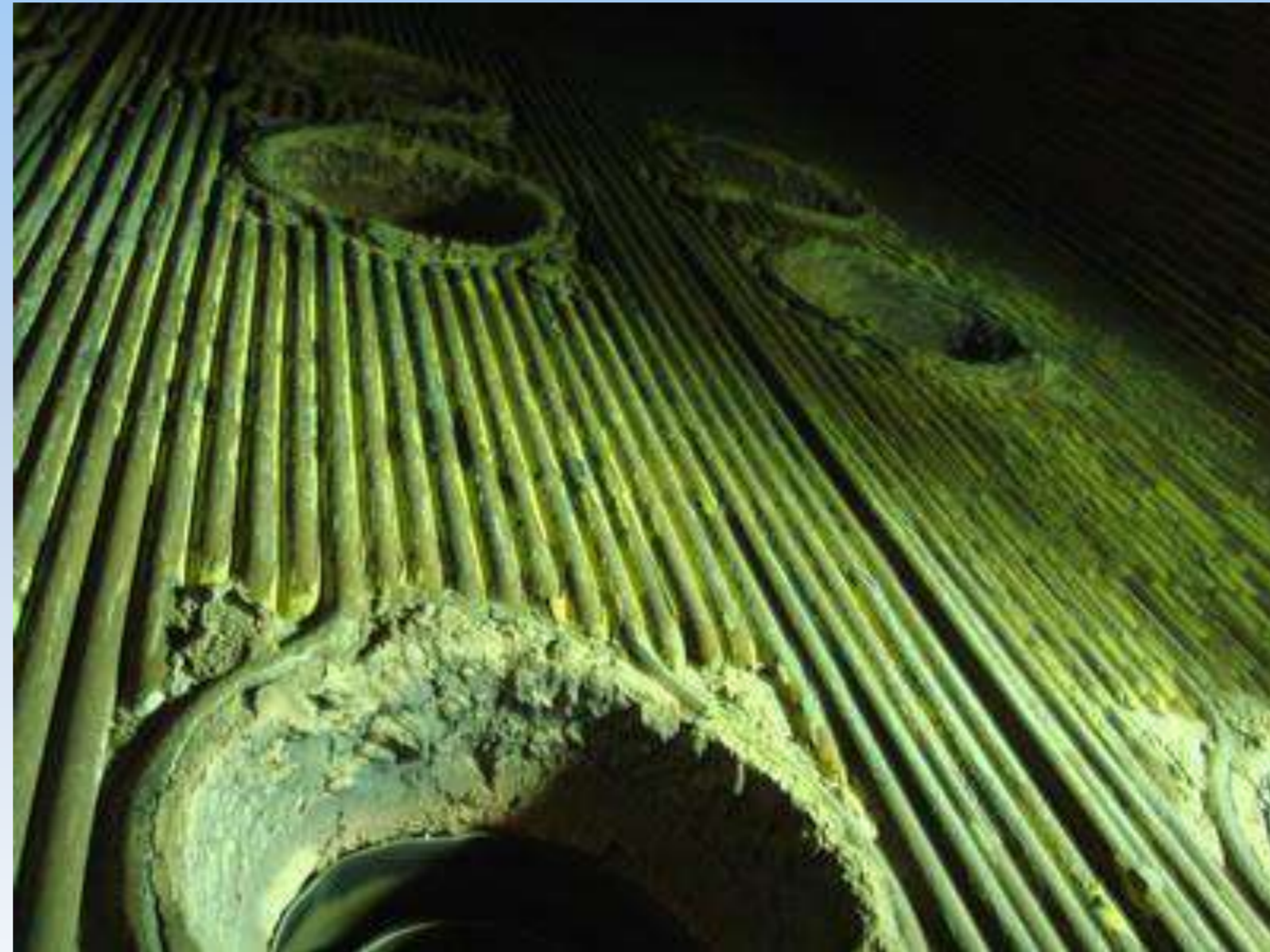
ボイラ蒸発管
