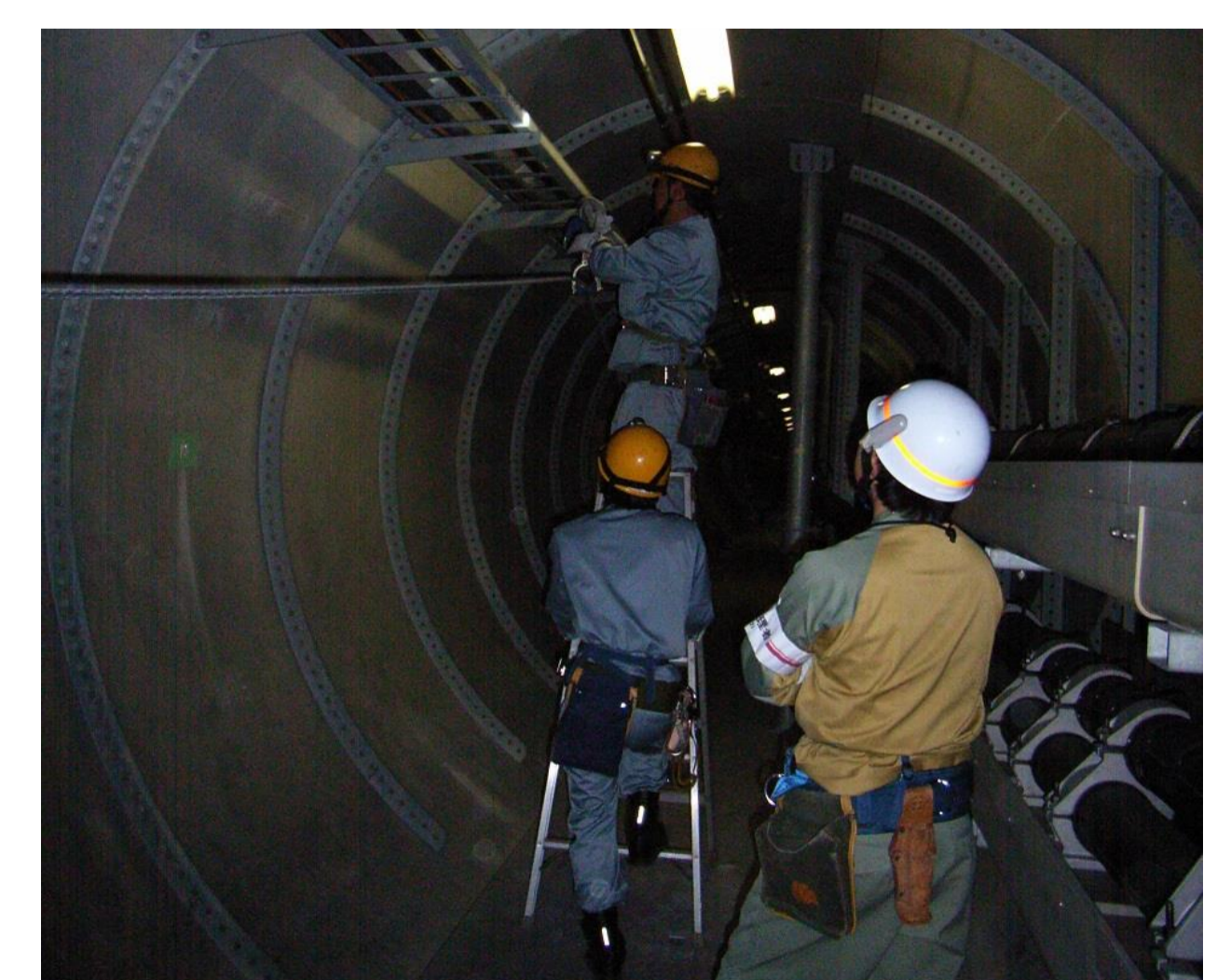
洞道内 通信実験
