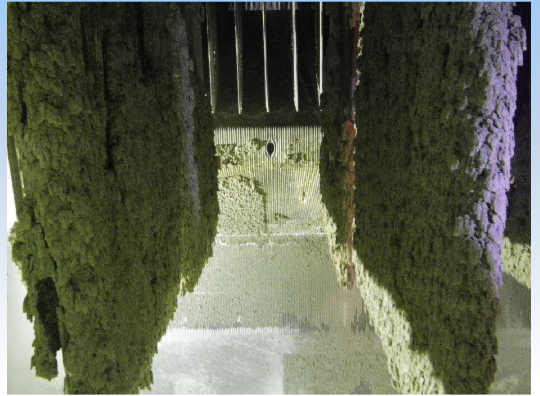
2年間運転後のクリンカ付着状況
