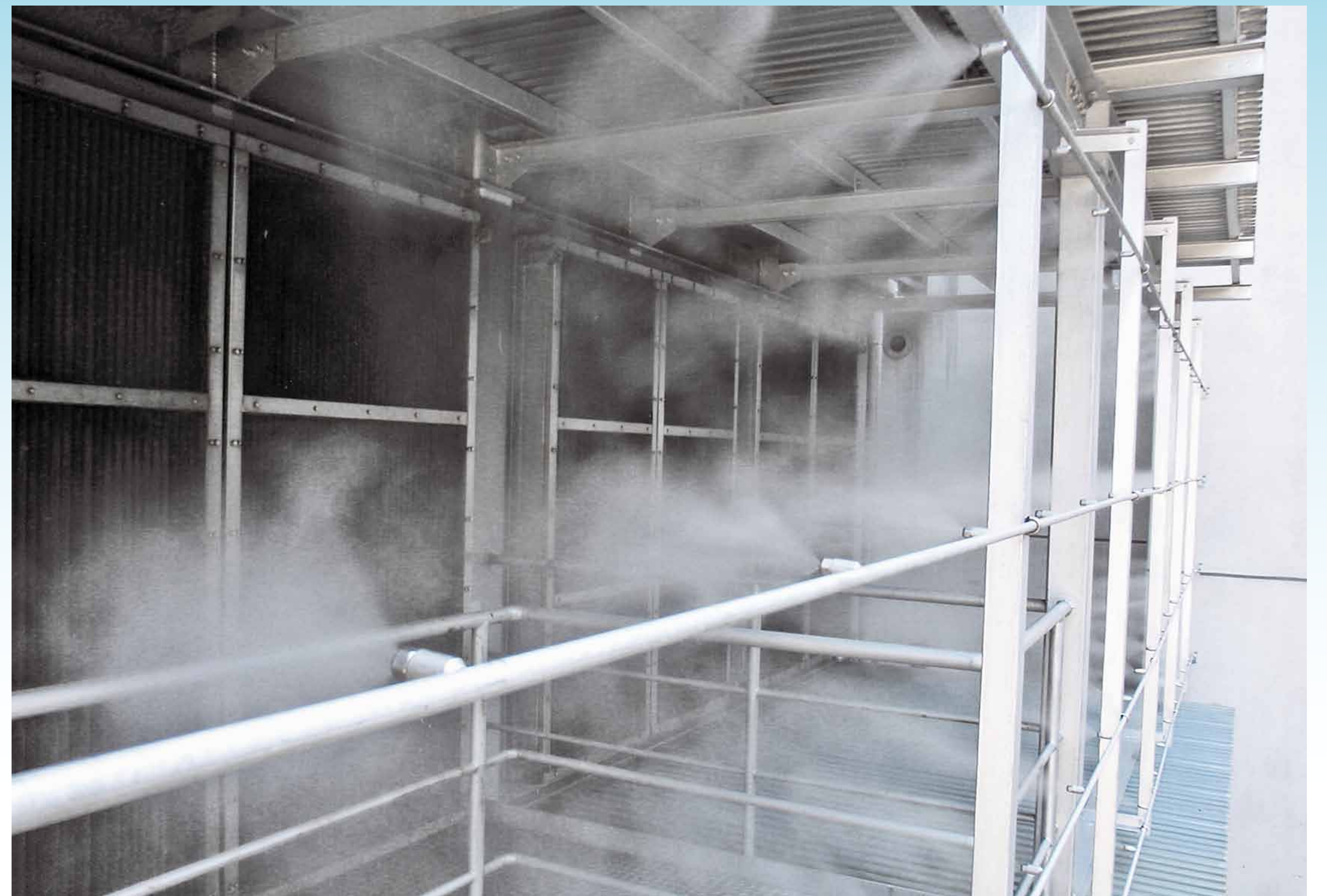
■ ミスト噴霧の様子(新名古屋火力発電所ガスタービン吸気室)
