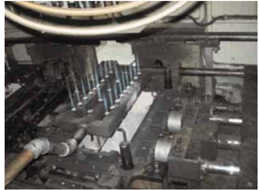
第5図 ガスバーナ式の設置状況
