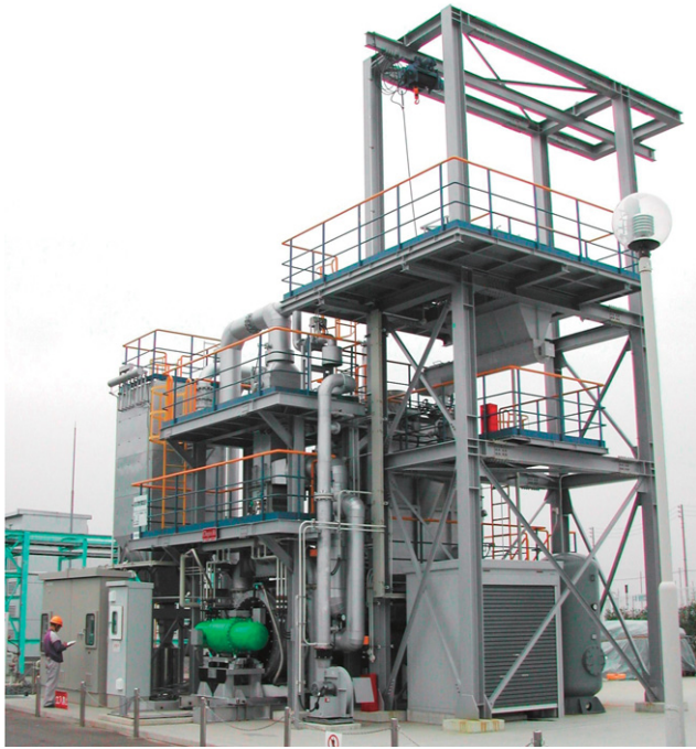
第6図 発電設備全景写真
