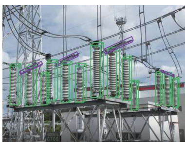
第1図 77kVラインスイッチと認識対象
