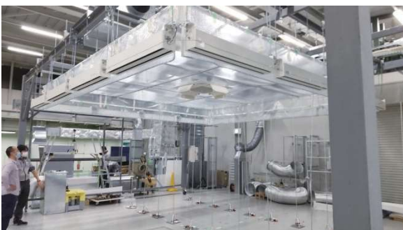
第3図 AC Zoneの外観
