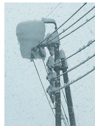
第1図 配電設備の冠雪例
