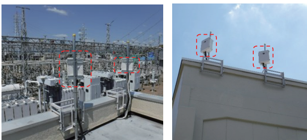
第3図 漏油検出の固定式カメラの設置状況
