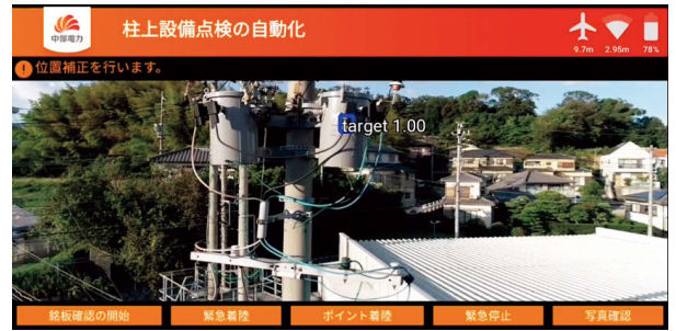
第5図 変圧器銘板認識時の動作画面
