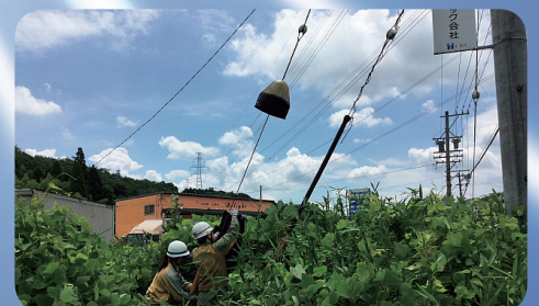
【電力安定供給】 新型つる巻き防止器の開発
