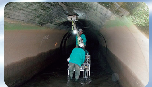
【土木建築技術】 低周波地中レーダによるトンネル背面の 深部空洞探査に関する基礎実験
