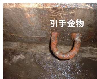
第1図 引手金物の腐食状況
