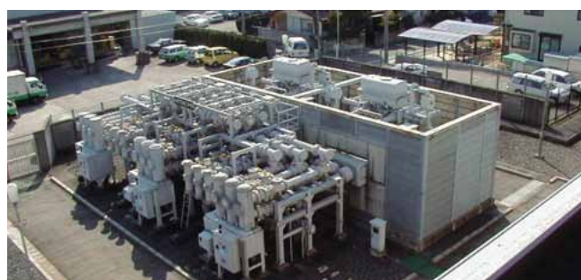
第1図 調査対象GIS (守山変電所)
