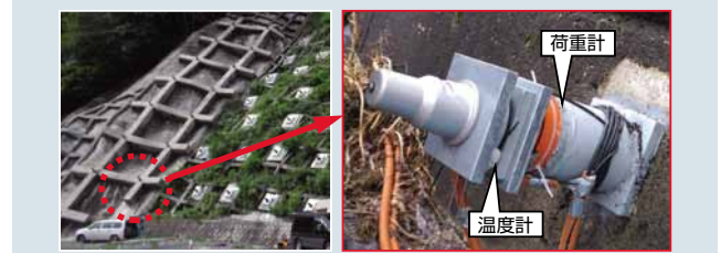
第1図 既設アンカーのり面と荷重計・温度計の設置状況
