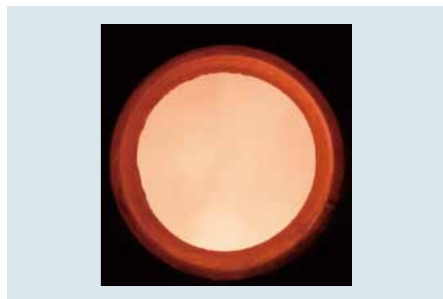
第3図 運転中のボイラ内の状況 (観察窓からデジタルカメラ(可視光)にて撮影)
