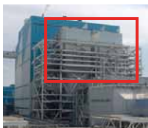
第1図 碧南火力発電所 排煙脱硝装置(囲み部)
