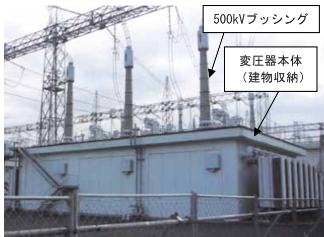
第1図 大規模修理対象変圧器 (500/275/70kV 1000MVA)
