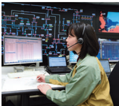
中央給電指令所における需給運用
