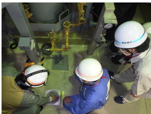
漏えい検知器の点検の様子
