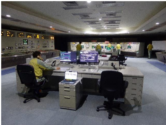
中央制御室を模擬したシミュレータの訓練の様子
