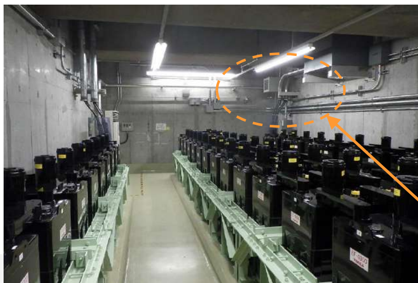
蓄電池室及び 空調吸い込み口例
