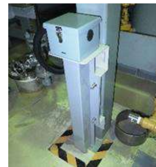
漏えい検知器
