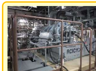
高圧注水設備 (タービン駆動)
