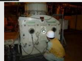
若手運転員の火力研修 巡視点検
