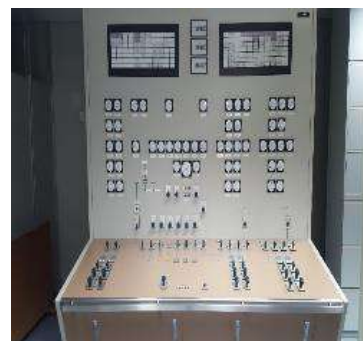
ガスタービン発電機操作盤
