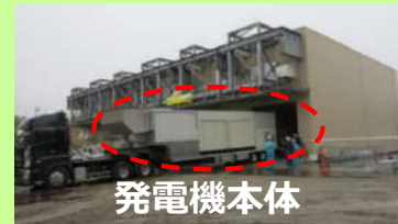
ガスタービン発電機
