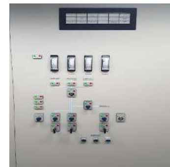
緊急時海水取水設備操作盤
