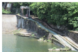
ダムに設置した魚道
