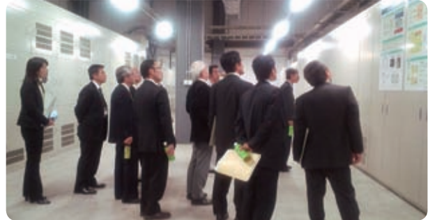
シャープ(株)亀山工場内の(株)シーエナジー亀山事業所の見学
