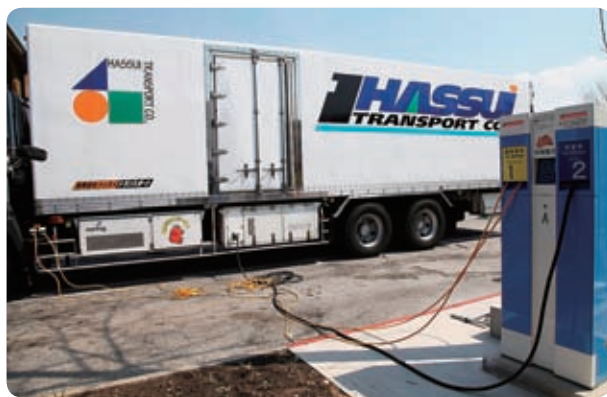
外部電源式アイドリングストップ給電スタンド
