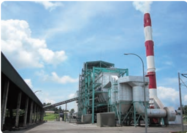
マレーシア パーム椰子房発電事業
