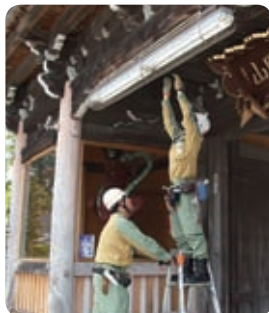
金剛寺(三重県尾鷲市)の電気設備点検
