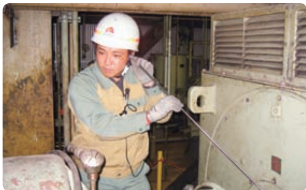
火力発電所で給水ポンプの駆動用モータの音を確認する作業
