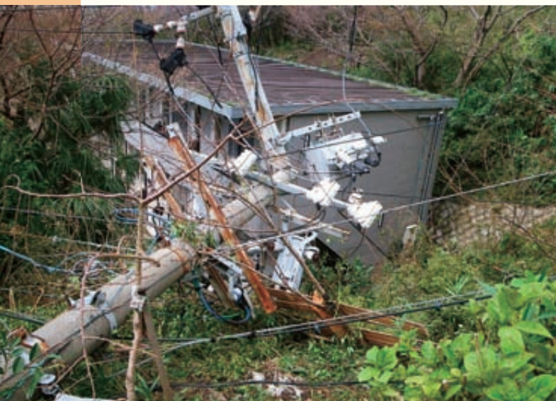
電柱折損の被害(愛知県蒲郡市)
