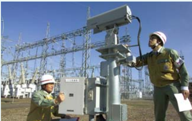
変電所の巡視・点検作業
