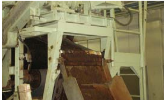
プレス機で汚泥を脱水処理する設備
