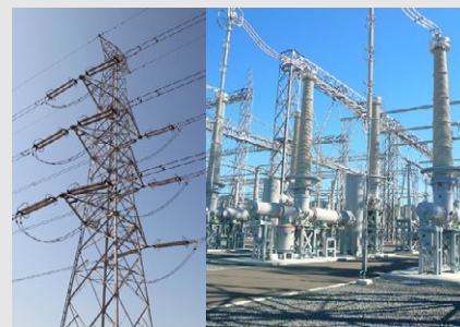
送電鉄塔と変電所
