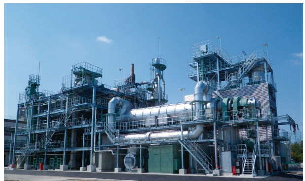
衣浦東部浄化センター 燃料化施設
