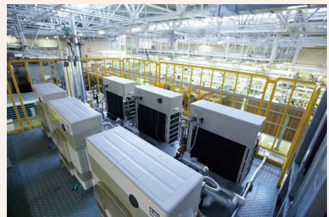
ヤマハ発動機(株)様 薬液槽加温システム
