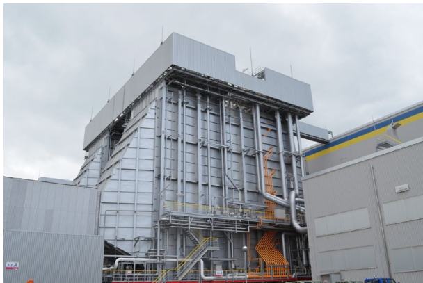
上越火力発電所における排煙脱硝装置
