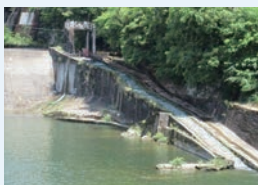
ダムに設置した魚道
