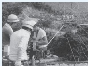
50万V基幹系統西部幹線建設(1972年完成)
