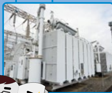
末広変電所 (三重県鈴鹿市)
