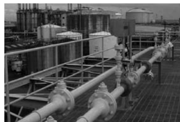
ガス導管供給
