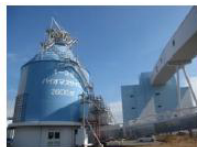
バイオマス燃料設備
