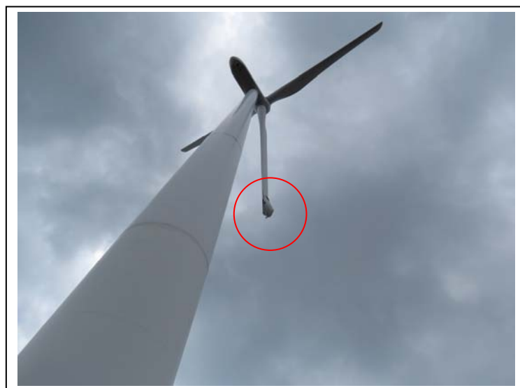
4号機ブレード破損箇所
