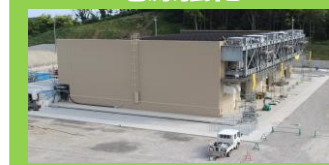
ガスタービン発電機
