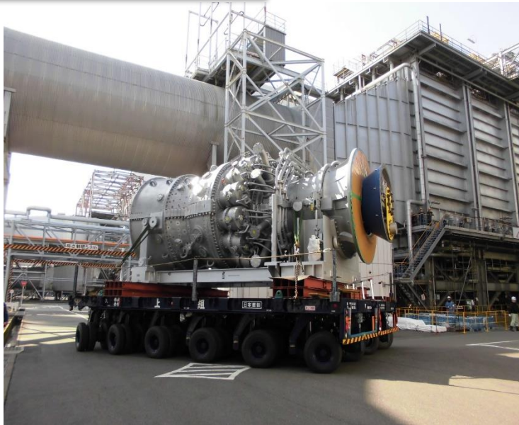
ガスタービンの発電所構内輸送
